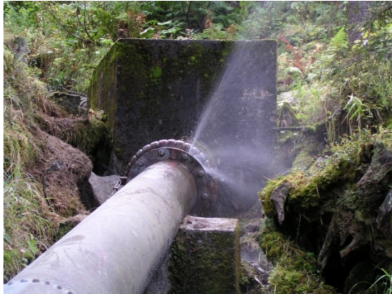
Druckrohrleitung, Undichtheit im Flanschbereich
